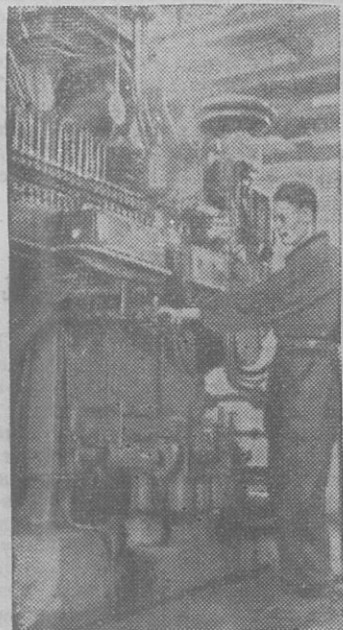
Газопровод Саратов — Москва Головная компрессорная станция № 1.
